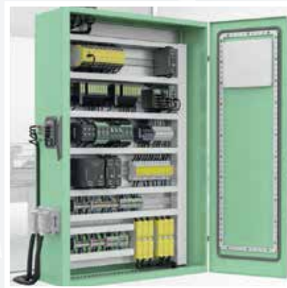
[1] Quadro de controlo
